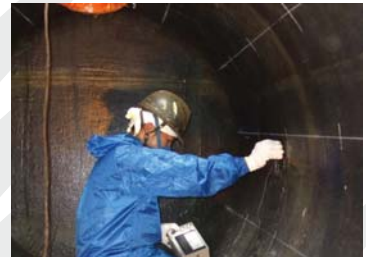
ピンホール及び膜厚検査
